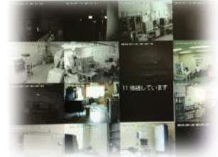
機器設置室への WEBカメラの設置(平成30年5月-)
